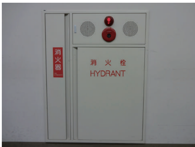
(a) 屋内消火栓
